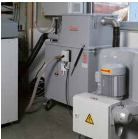
NA 250 Stahlblech ohne Reststaubfilter mit Saugaggregat in der Kunststoffverar- beitung
