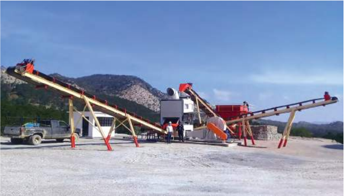
Eine Barit-Aufbereitungsanlage (Bariumsulfat \text{BaSO}_4 ) in Mexiko
