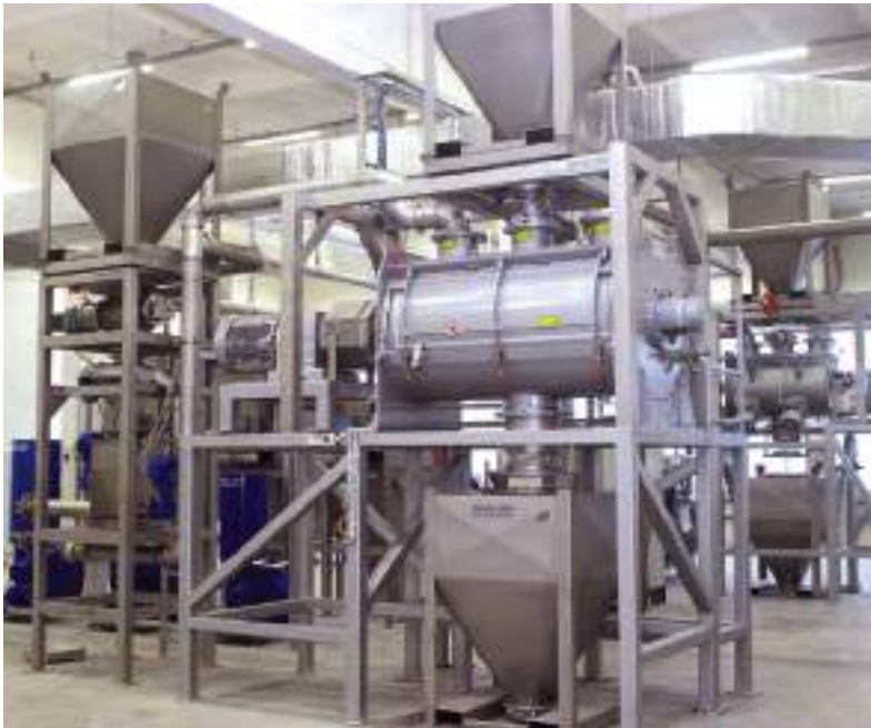
Mischanlage und semiautomatische Abfülllinie
