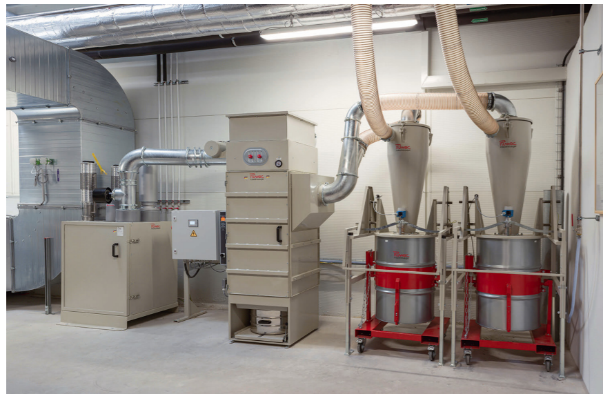
Absauganlage bei Geplast mit zwei Vorabscheidern (rechts), Filtereinheit (Mitte, aus der DS6-Serie) und Antriebsaggregat (links). © Ruwac
