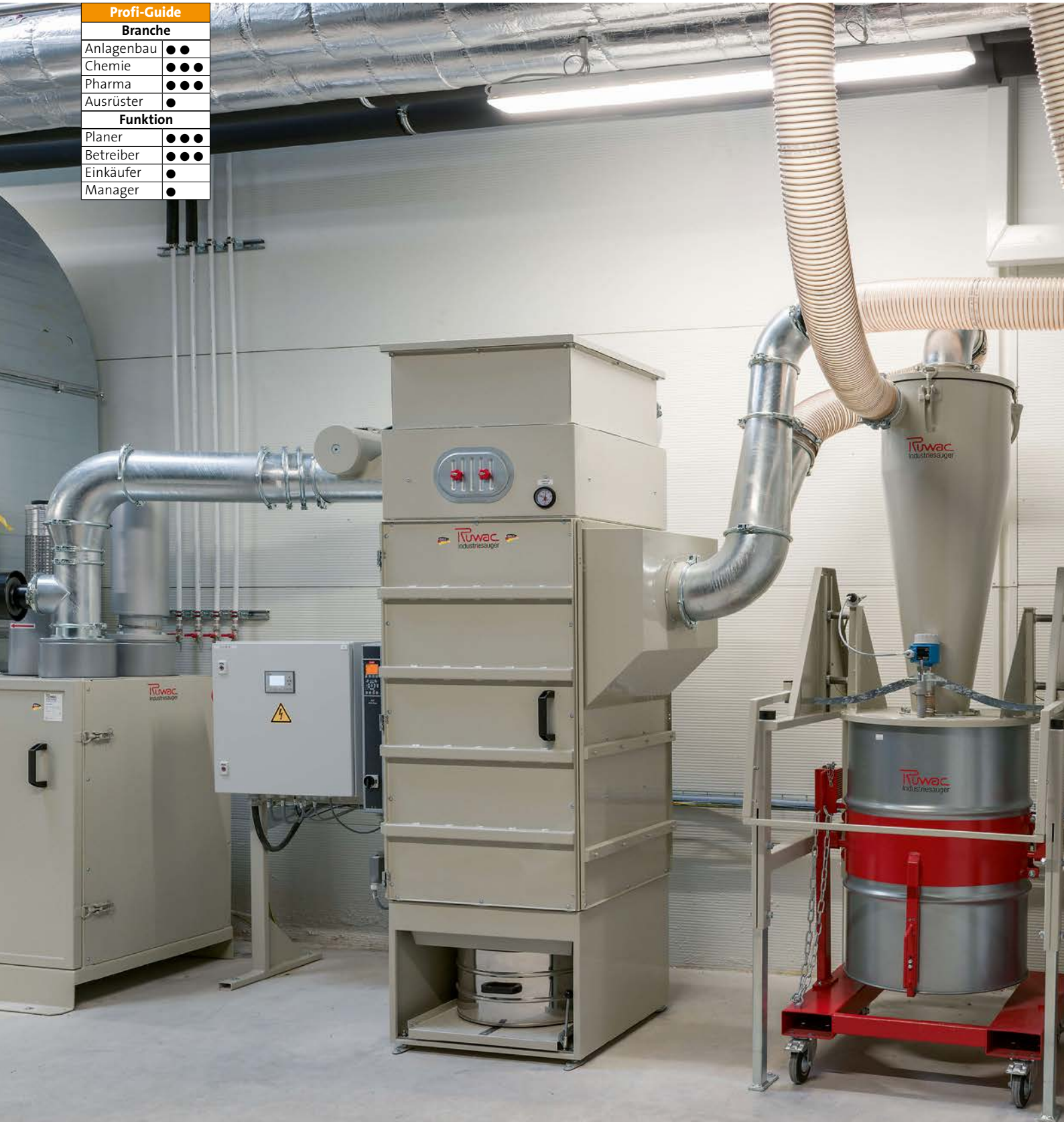
Absauganlage mit zwei Vorabscheidern (rechts), Filtereinheit (Mitte) und Antriebsaggregat (links).
